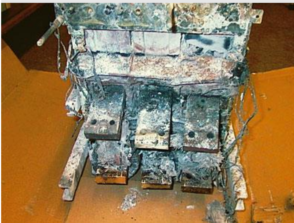
Рис. 2. Выключатель, поврежденный в результате длительного перегрева
